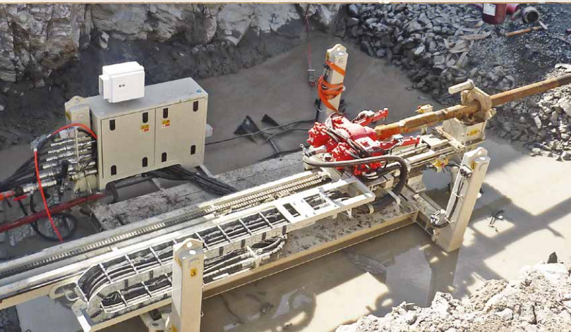
Perforatrice speciale su skid per perforazioni orizzontali Special skid mounted drill rig for horizontal drilling
